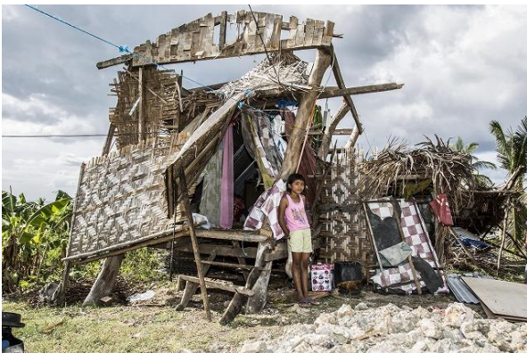
■ 台風で屋根が飛ばされ、壁が崩れかけている家が、被災後いたるところで見かけられました (2013年12月14日、セブ島北部)
