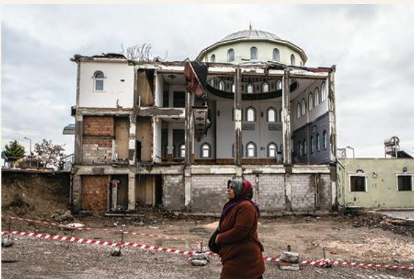
地震で壁が崩壊したモスク＝トルコ南東部アドゥヤマン県ベスニ地区で2023年12月11日（川畑嘉文撮影）
