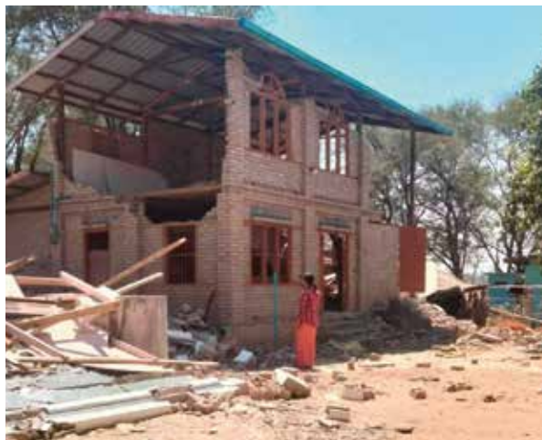
倒壊した家屋の前に立ち尽くす、AARが運営する職業訓練校（ヤンゴン）の修生の女性シュエさん（仮名）＝マンダレー地域で2025年3月30日
